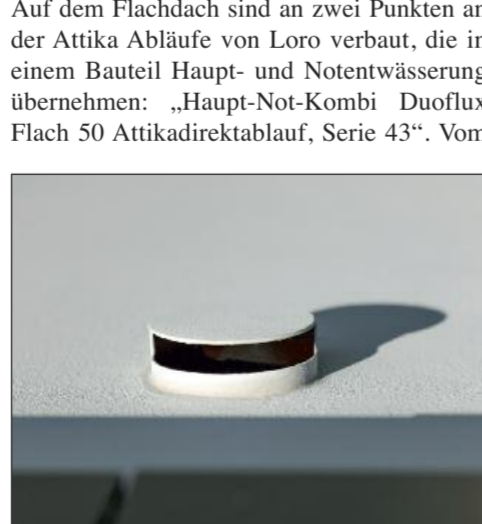
Damit die Entwässerung das Fassadenbild nicht stört, verlaufen die Falleitungen hinter der Fassade. Nur für die Entlüftung der Rohre ist ein Durchbruch notwendig. Dies ist elegant mit einer „Wuppertaler Blende“ im Farbton des Fassadenputzes gelöst. Von unten ist die Blende geschlossen und fügt sich so harmonisch in die Fläche ein.
